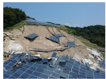
土砂崩れで生じた崩落
